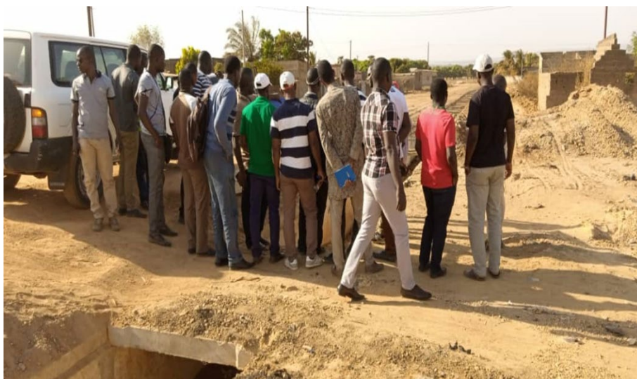
Visite des chantiers avec les acteurs de mise en œuvre du projet à Banfora
