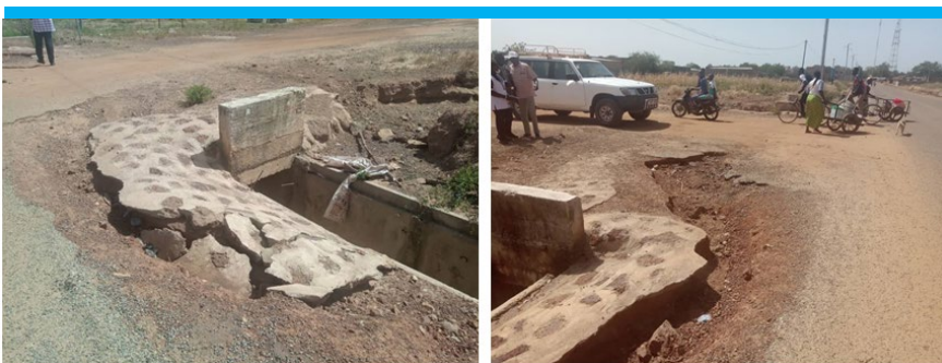
Etat de dégradation des travaux du 11 décembre 2019 à Ouargaye constaté en 2020
